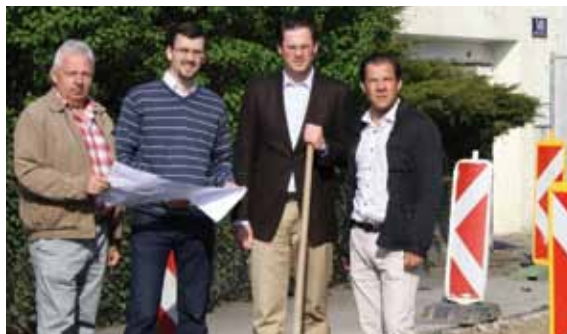
Bürgermeister Mag. Stefan Schmuckenschlager (2.v.r.) überzeugte sich mit STR Mag. Roland Honeder (2.v.l.) und Ing. Peter Neubauer (r.) vor Ort bei Polier Roman Weber vom Fortschritt der Bauarbeiten.
