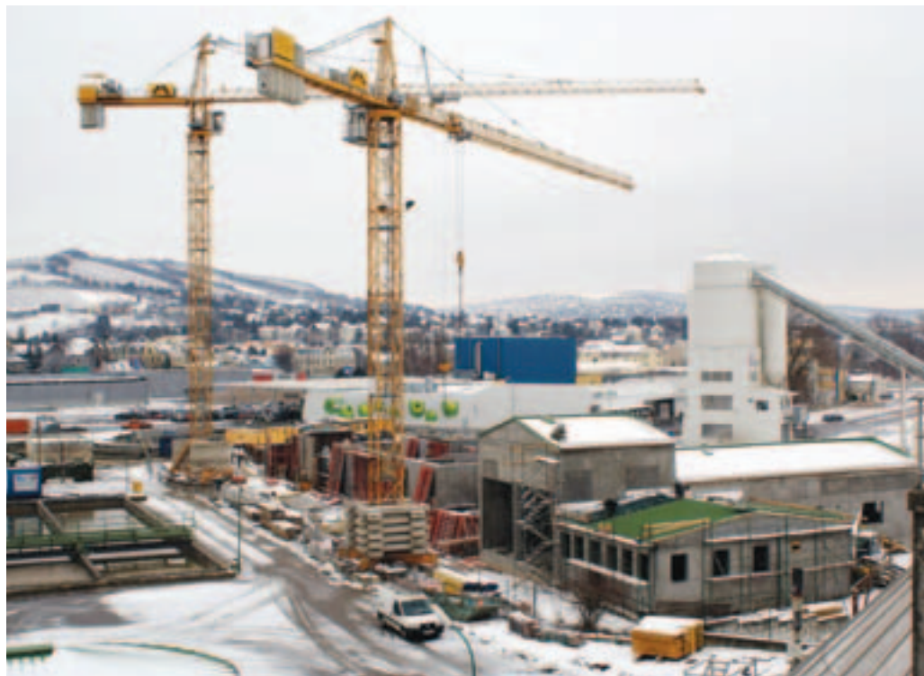
Die Arbeiten für die biologische Kläranlage laufen trotz der winterlichen Witterungsverhältnisse auf Hochtouren.
