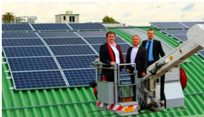
Die Stadträte Dr. Stefan Mann, Karl Schmid und Energieeffizienzstadtrat Mag. Roland Honeder inspizierten die neue Photovoltaikanlage vom Hebe- kran aus (v.l.).
